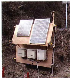
変換器・通信装置 (太陽電池・バッテリー運用)
